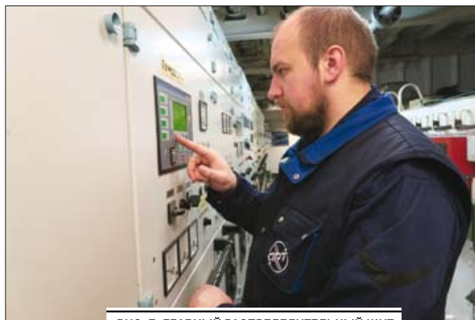
РИС. 7. ГЛАВНЫЙ РАСПРЕДЕЛИТЕЛЬНЫЙ ЩИТ
