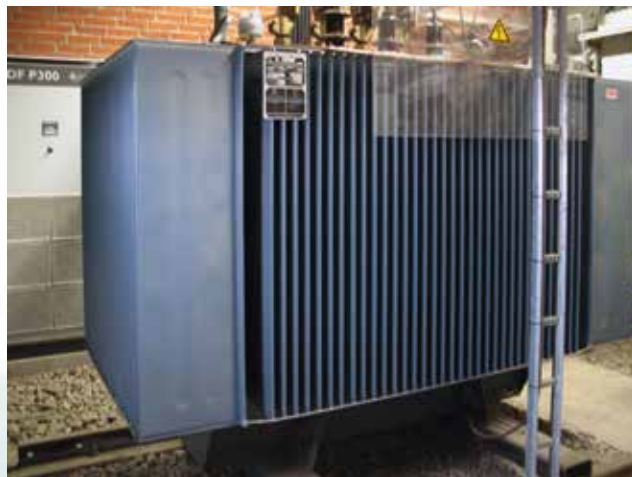
Согласующий трансформатор системы динамической компенсации
