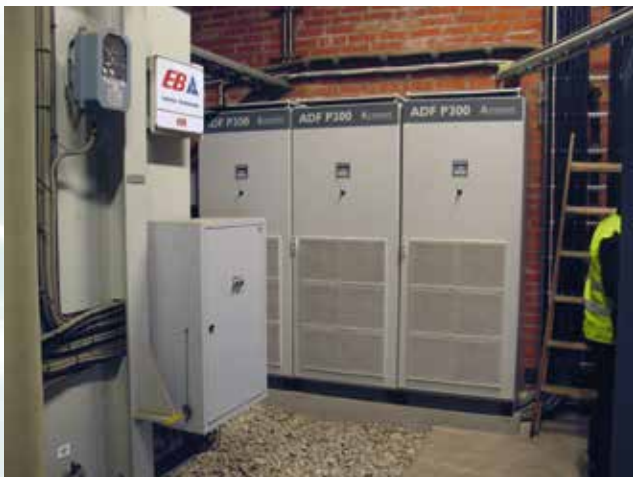
Активные динамические фильтры на трансформаторной подстанции
