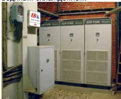
Активные динамические фильтры на трансформаторной подстанции
