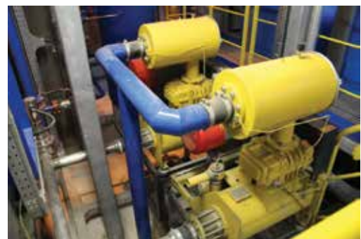
Пример. Электроприводы компрессоров барьерного воздуха газоперекачивающих агрегатов
