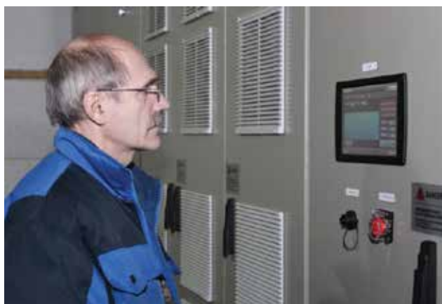
Наладка переходных режимов пуска преобразователя частоты HYUNDAI N5000 от паротурбинной установки мощностью 1 МВт.
