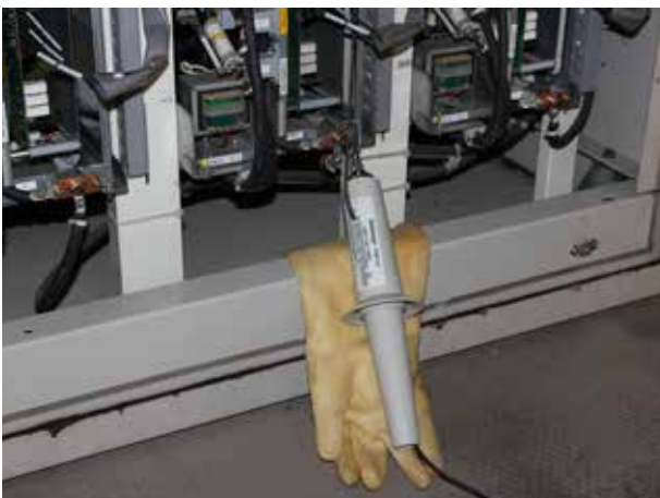
Измерение формы напряжения на выходе высоковольтного преобразователя частоты после замены конденсаторов ячеек
