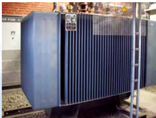
Согласующий трансформатор высоковольтной системы динамической компенсации
