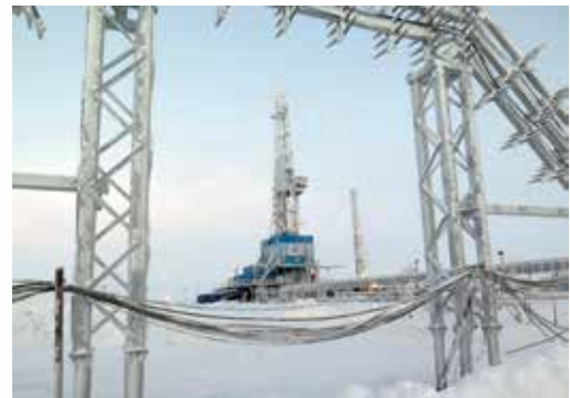
Пример. Электроприводы буровых установок
