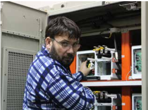
Восстановление дефектных ячеек высоковольтного преобразователя частоты «N5000»
