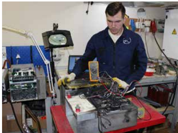
Дефектация ячейки высоковольтного преобразователя частоты «Robicon»
