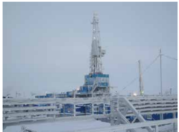
Пример – электроприводы буровых установок
