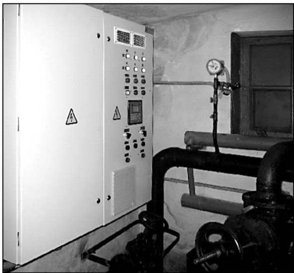
Рис. 2. Шкаф системы частотного регулирования на одной из насосных станций Нижнего Новгорода
