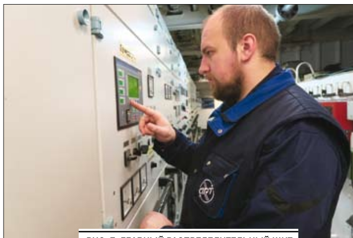
РИС. 7. ГЛАВНЫЙ РАСПРЕДЕЛИТЕЛЬНЫЙ ЩИТ
